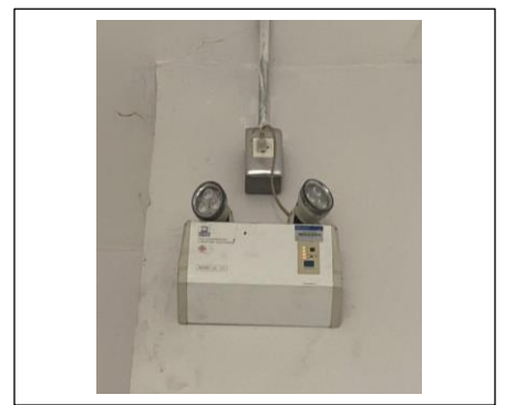
ไฟฟ้าฉุกเฉิน
